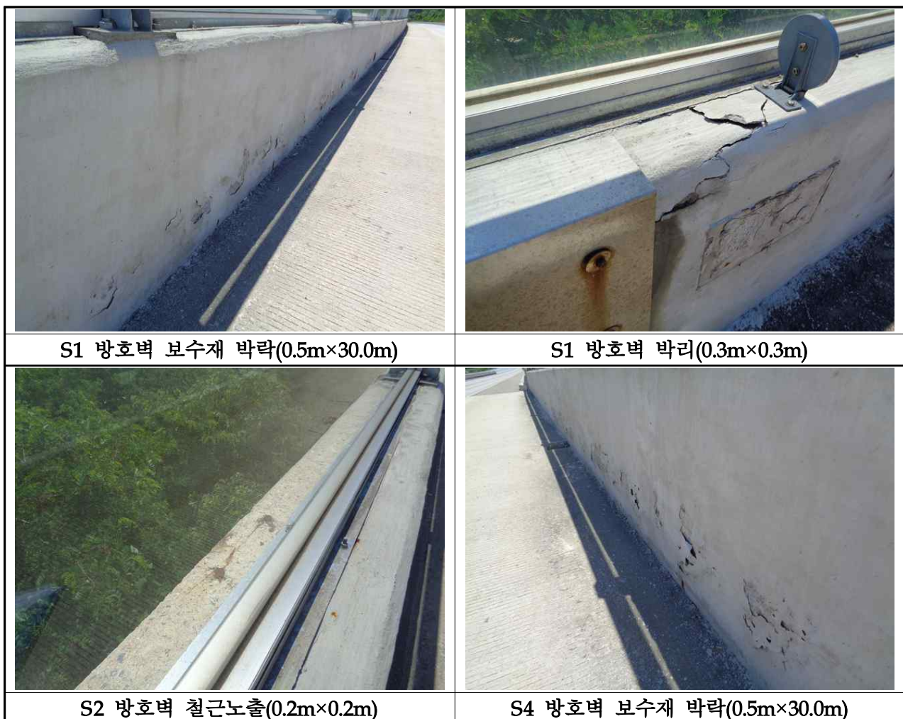
【사진 3.26】 방호벽 및 중앙분리대 손상현황
