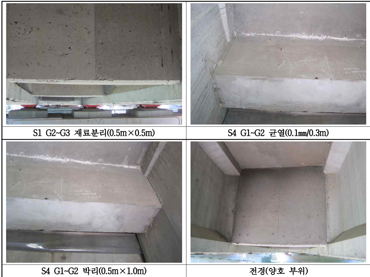
【사진 3.8】 가로보 손상현황
