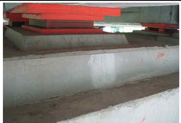
P3-Sh3 받침 균열(0.2mm/0.3m)
