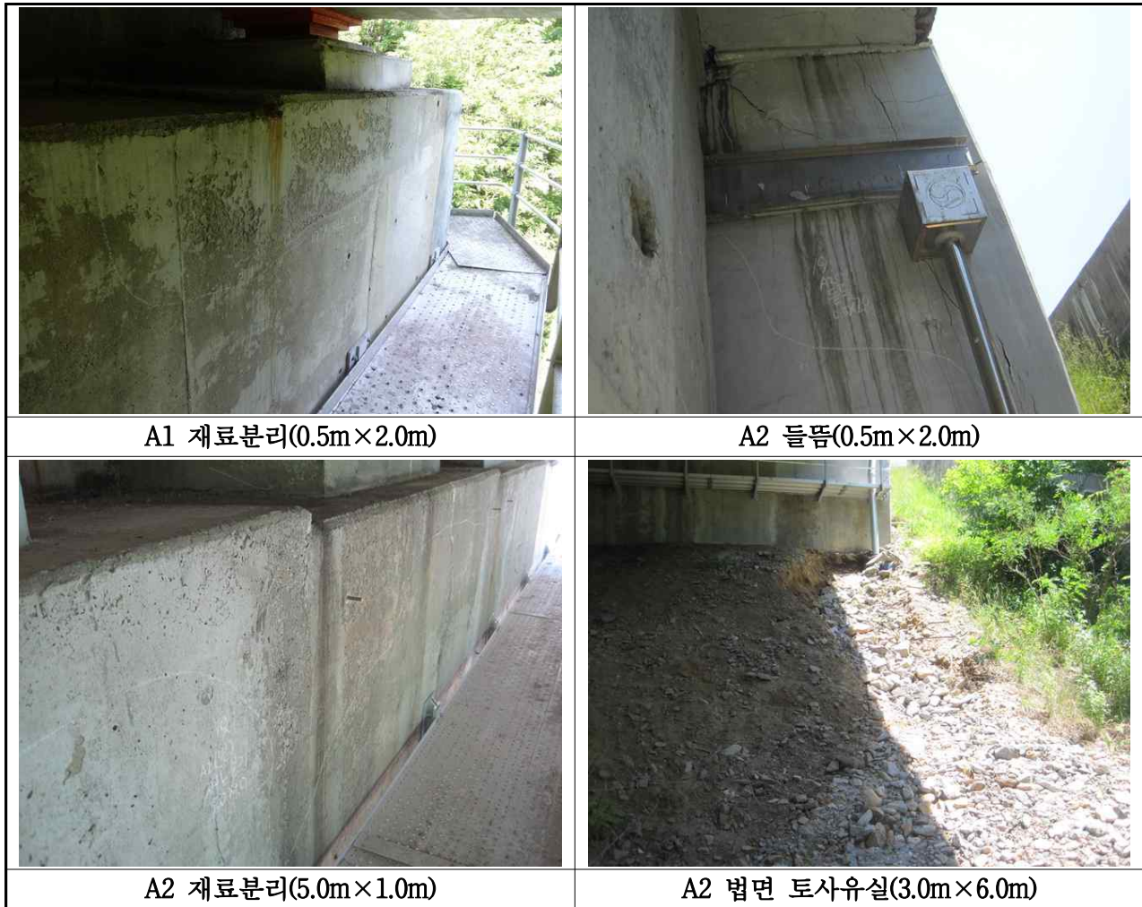
【사진 3.11】 교대 손상현황
