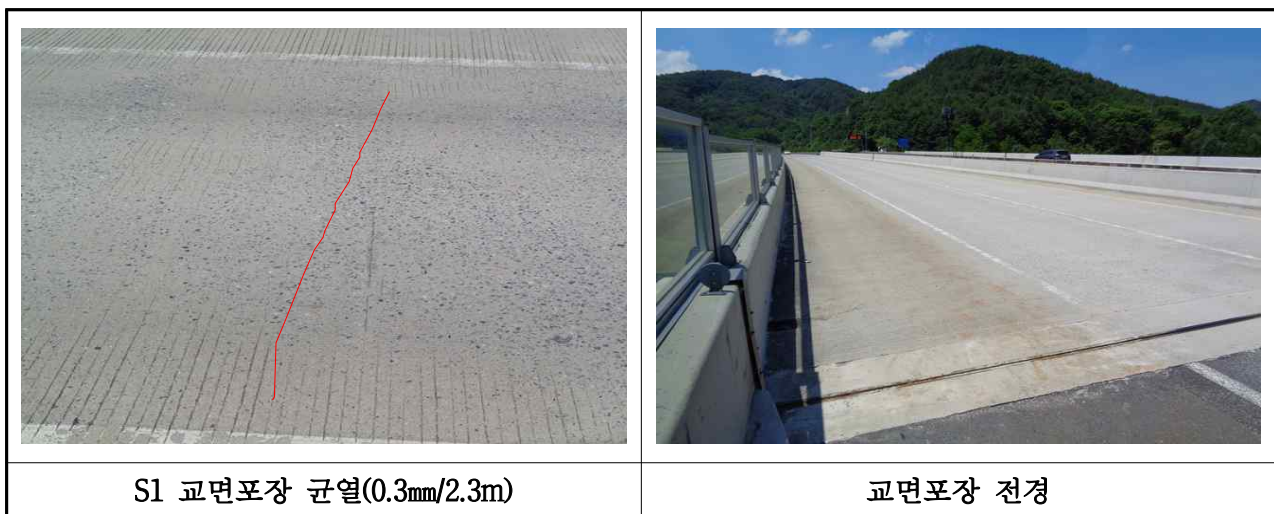
【사진 3.22】 교면포장 손상현황
