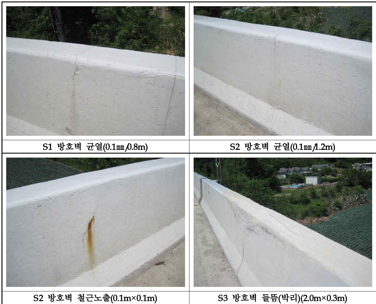
【사진 3.26】 방호벽 및 중앙분리대 손상현황
