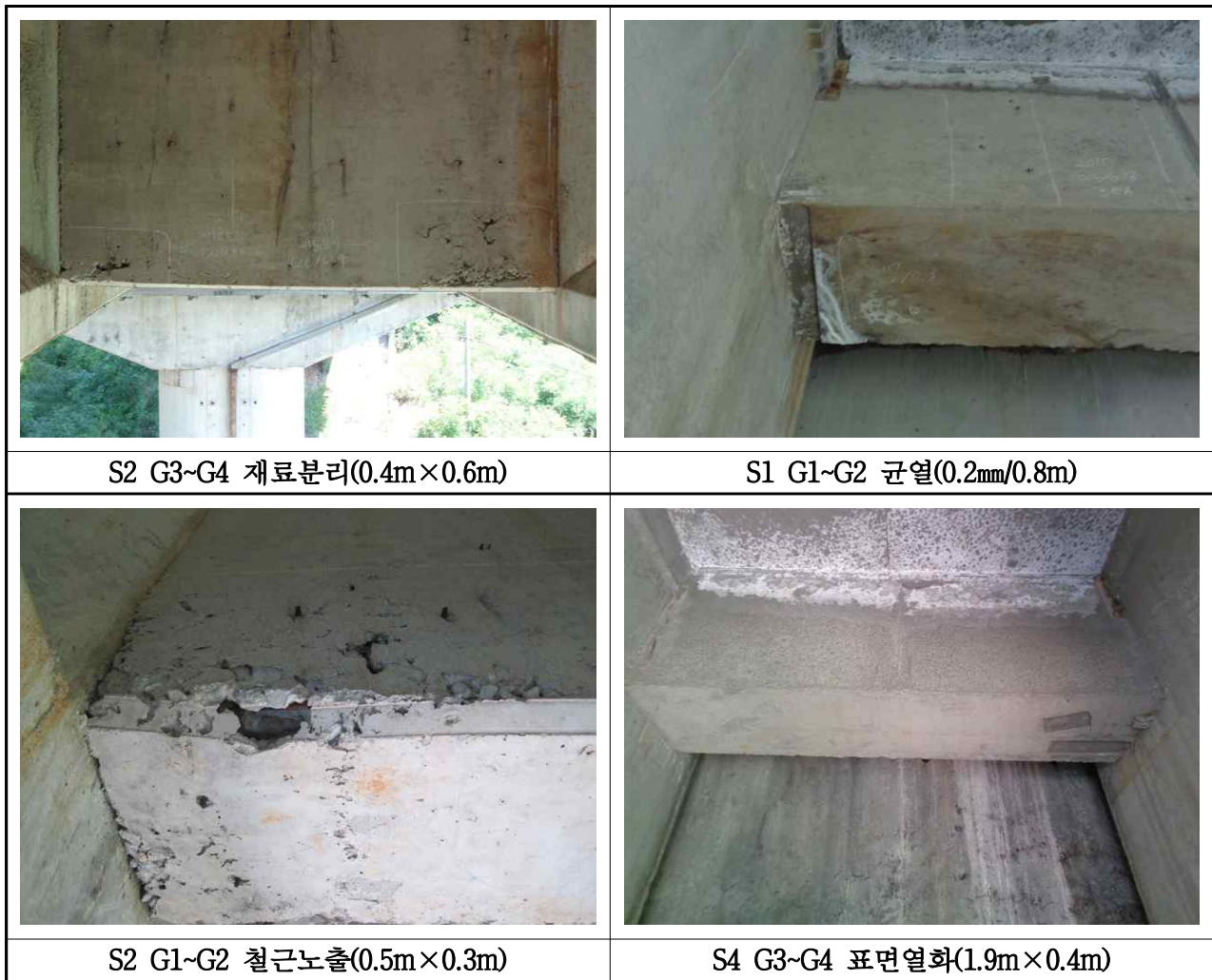
【사진 3.8】 가로보 손상현황
