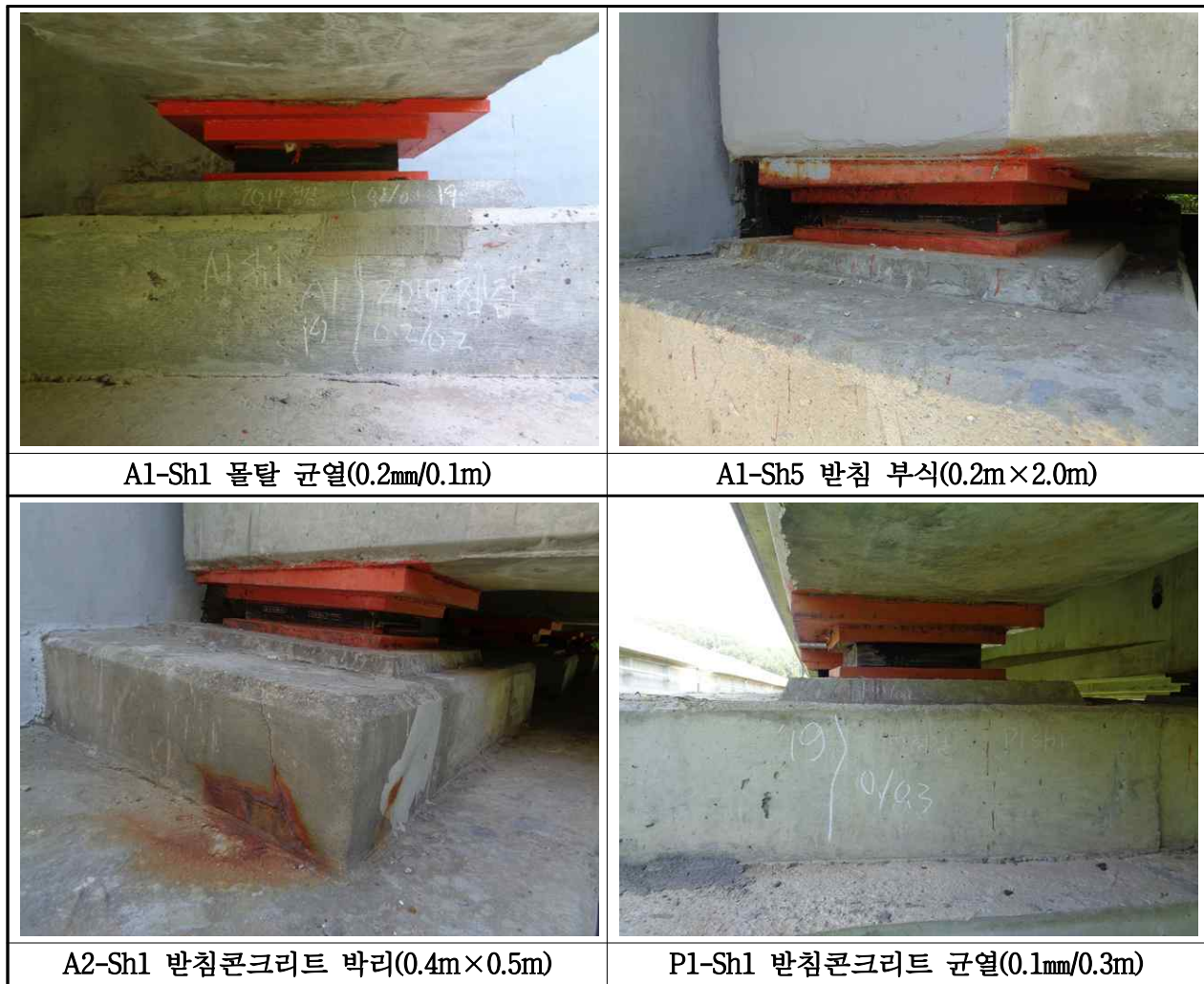
【사진 3.15】 교량받침 손상현황
