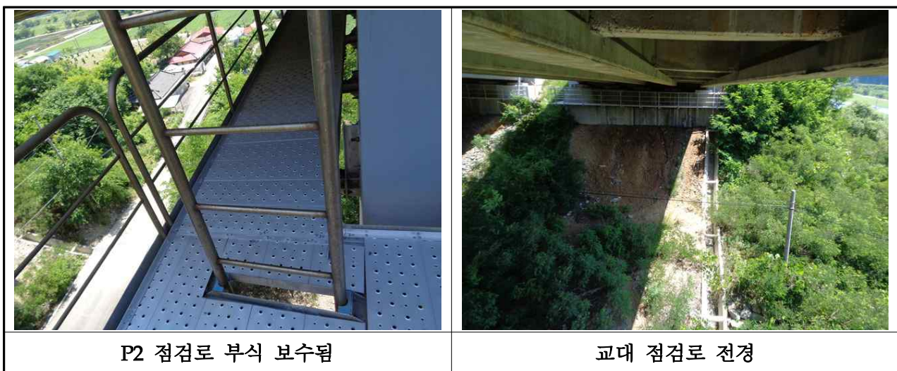
【사진 3.51】 교량 점검시설 손상현황
