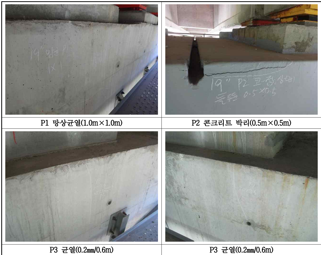
【사진 3.13】 교각 손상현황
