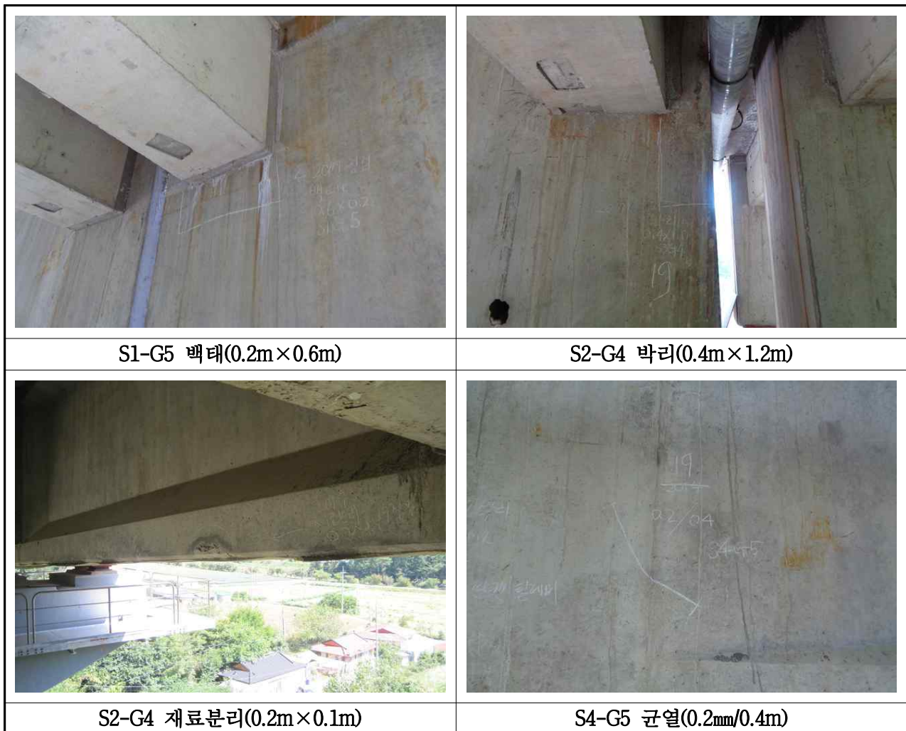
【사진 3.6】 거더 손상현황
