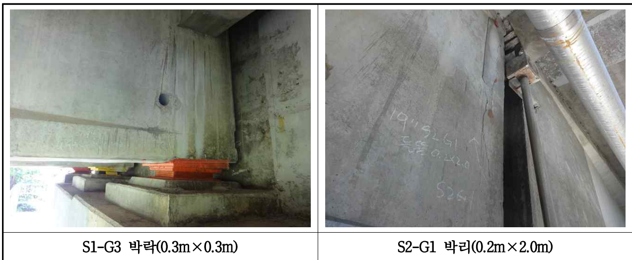
【사진 3.6】 거더 손상현황
